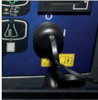
1. Schalter prüfen (I = an / O = aus).
